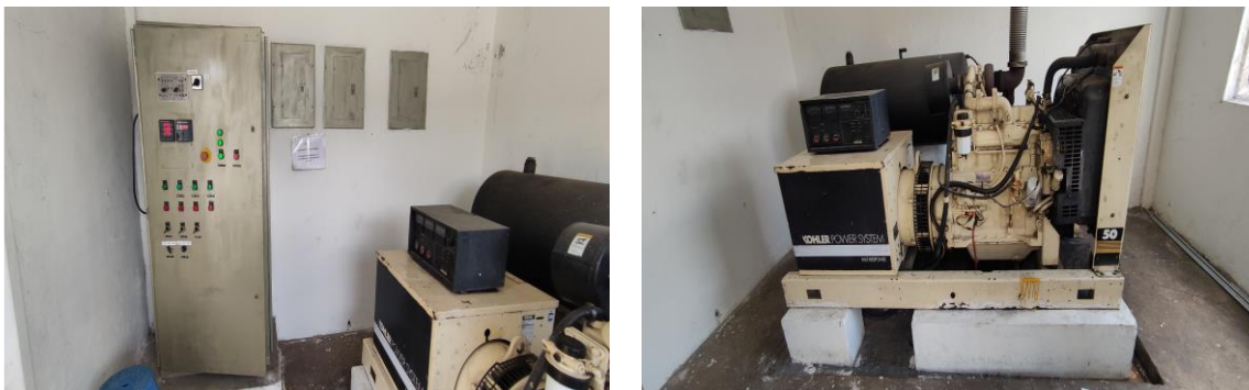
Gráfico 5. Generador eléctrico de la EDS y área de tanque de combustible
