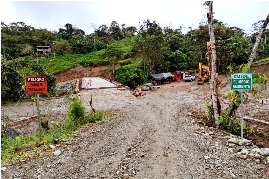
Anexo N° 5. Señalización ubicada en obra
