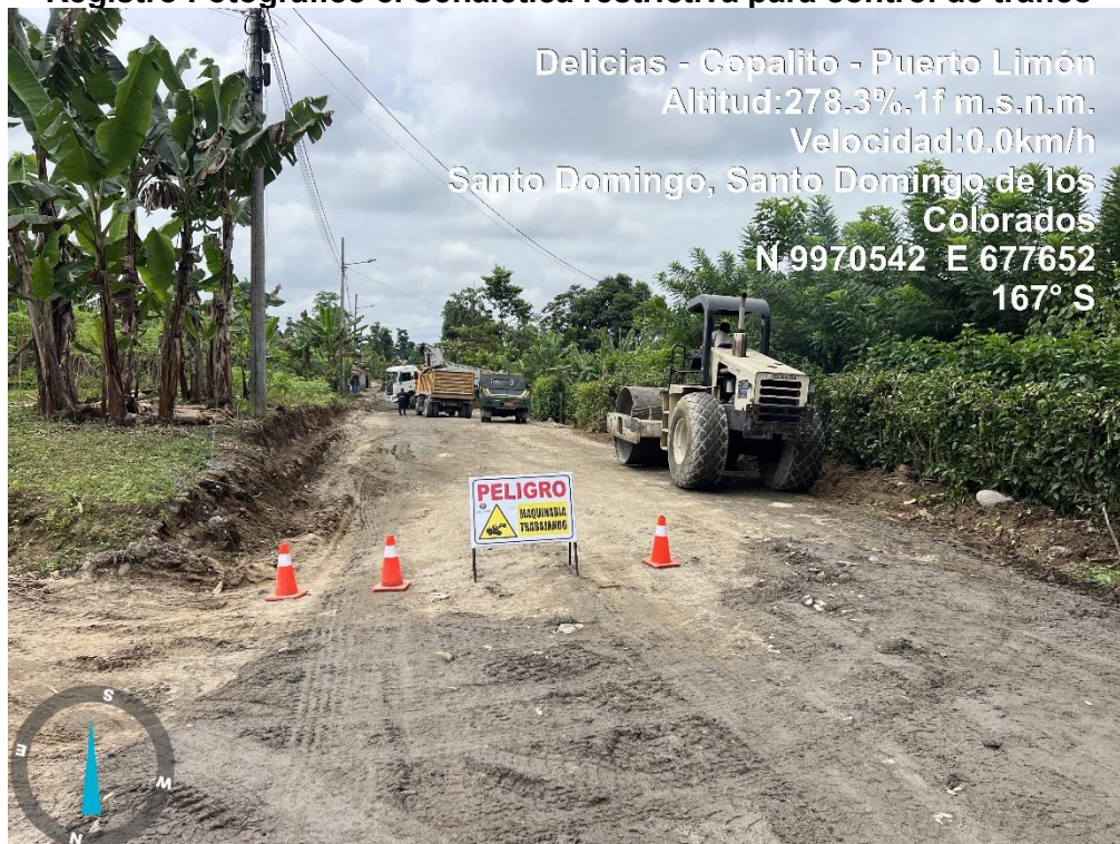
Registro Fotográfico 8. Señalética restrictiva para control de tráfico
